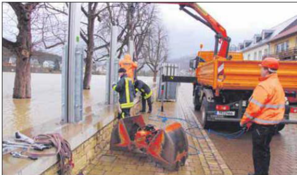
700 Meter Spezial-Deich: Frauen und Männer der Freiwilligen Feuerwehr Oberbillig und Mitarbeiter des Konzer Bauhofs sichern Oberbillig vor den Fluten der Hochwasser führenden Mosel. TV-Foto: Klaus D. Jaspers
